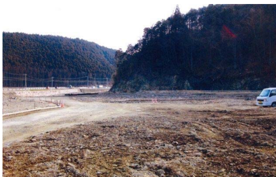
▲西戸橋復旧前
