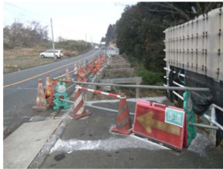
▲(主)古川佐沼線 迫町北方 被災状況
