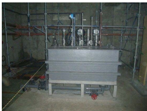
▲流入水質測定装置設置状況
