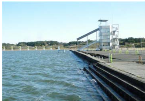
▲長沼ダム 護岸 被災状況
