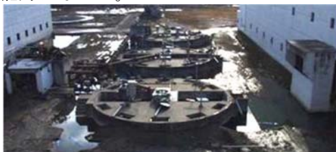
▲重力濃縮槽被災後
