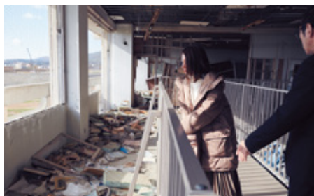
破壊された窓はそのまま。荒れた室内を間近で見ることができます。
