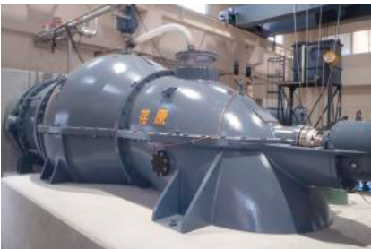
写真:五ヶ村堀排水機場のポンプ
